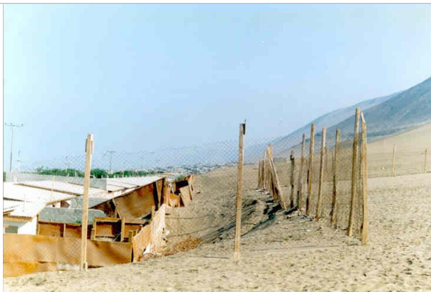
2.6.- Vista de la situación que afecta a las viviendas de la Población Huantajaya III, calle Los Algarrobos y calle 4, localizada al pie de la duna El Dragón. Se aprecia el proceso de recuperación de perfiles de equilibrio después de corte de talud y precipitación de arenas sobre la construcción. Las arenas avanzan sobre los sitios, desestabilizan muros, invaden las casas por acción del viento. Foto: gentileza de Edgardo Gaete.
