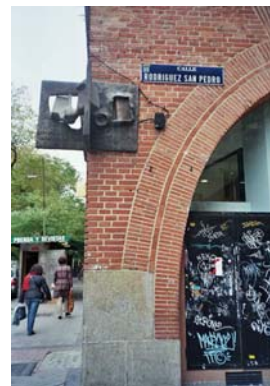
Fig. 31. Intervención no restaurativa, por meteorización del zócalo de ladrillo en esquina principal del edificio, frente de calle Rodríguez San Pedro (bajo placa conmemorativa de la residencia de Pablo Neruda). Foto. M.I.P., 2006. ©
