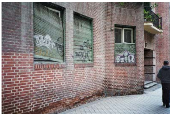
Fig. 30. Zona de fachada con marcos de ventanas y postigos originales actualmente deteriorados; se observa también la meteorización de los zócalos de ladrillos. Si bien en la época se usaban los sillares de granitos para realizar los zócalos, esto no ocurrió en la Casa de las Flores, dado que FOCSA, queriendo promover el ladrillo de su fábrica de cerámica, ofreció este material en abundancia. Fachada en calle de Gaztambide Foto. M.I.P., 2006. ©
